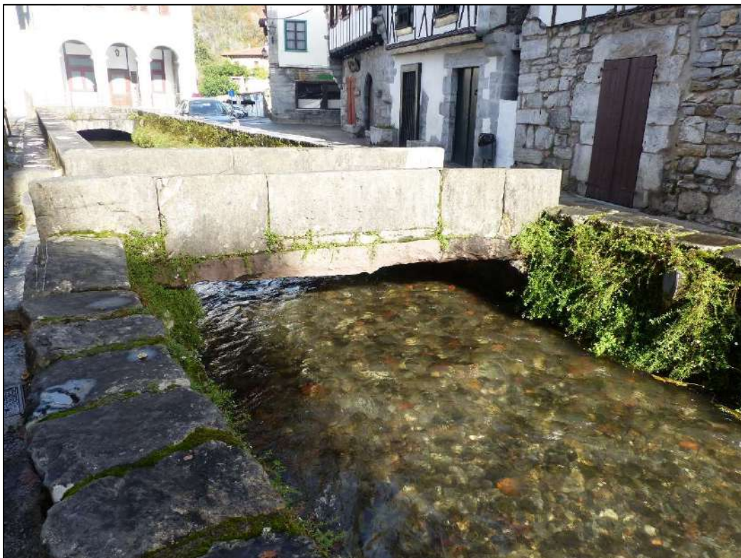
Figura 40 Imágenes tomadas en el tramo de la regata Onin, en su trazado canalizado por el casco urbano de Lesaka. En esta zona del tramo de la regata por Beheko Plaza, la escasa capacidad hidráulica de los puentes peatonales, puede dar lugar a desbordamientos, principalmente en la margen izquierda de la regata.
